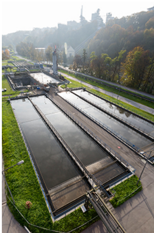
In der ersten Biostufe des Abwasserreinigungssystems am Standort Burghausen wird organisch belastetes Abwasser geklärt.
